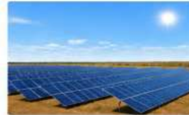
محطة الطاقة الشمسية
